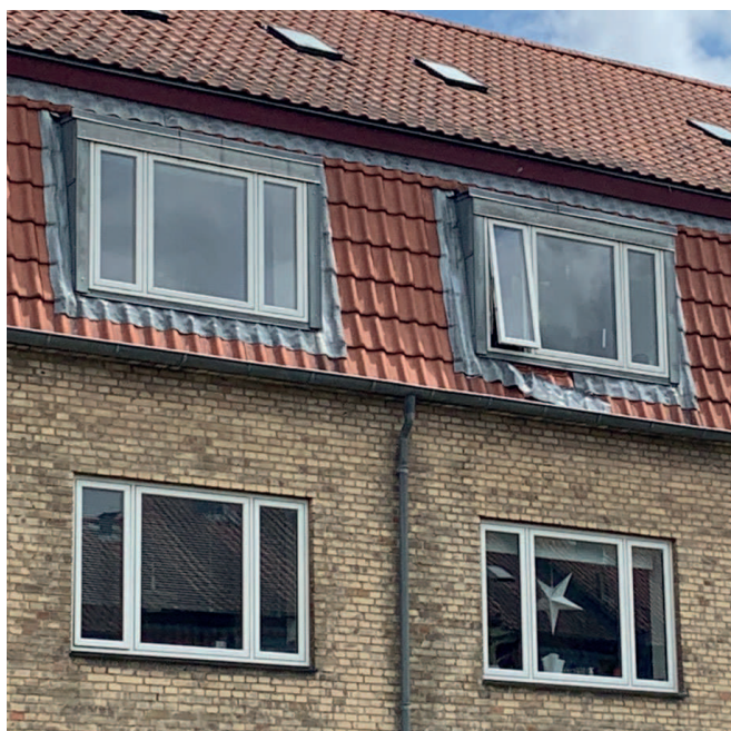
Tag omlægges pga. mange defekter og fejl i undertag
