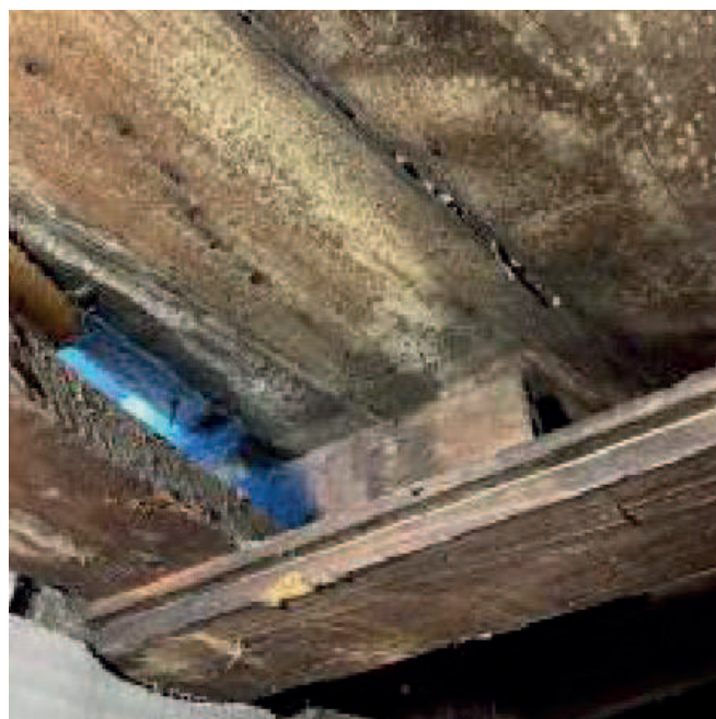
Kraftige fugtskjoler og skimmel på loft, som følge af utætheder MKB, BYGNINGSFORNYELSE
