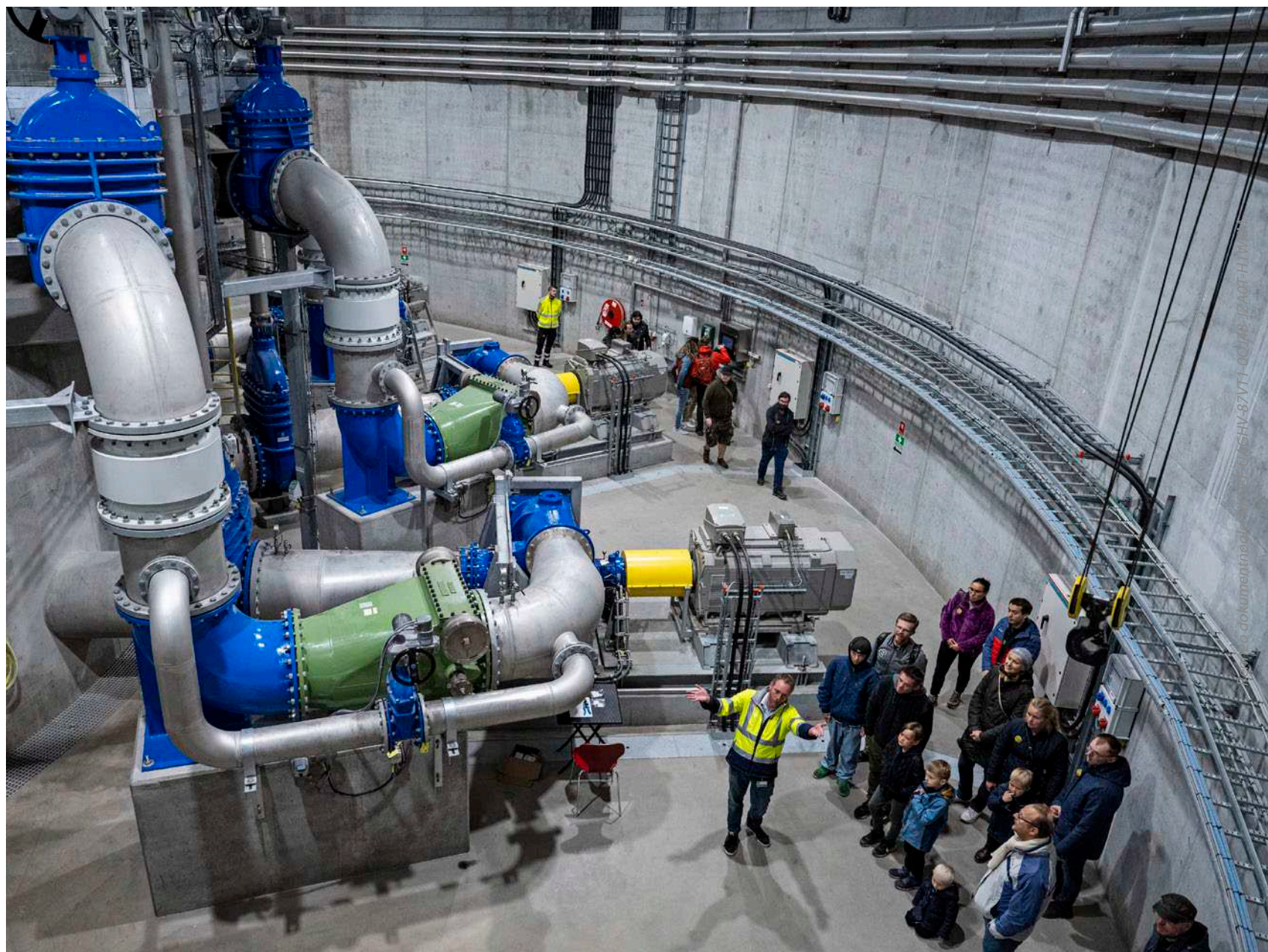
Kulturmaten 2022 på Kløvermarken Pumpestation på Amager
