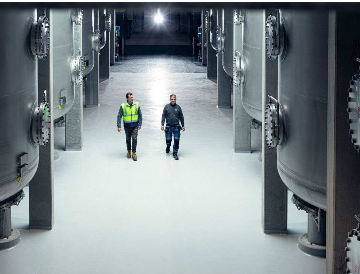
Filtersalen på Værket ved Søndersø
