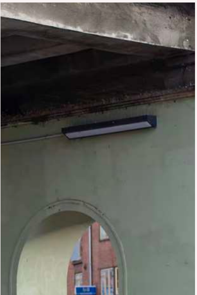
Påbygget armatur: Fagerhult 'Tuscan' - vinklet profil
