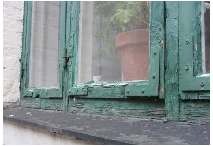
Originale vinduer er nedslidte og udskiftes
