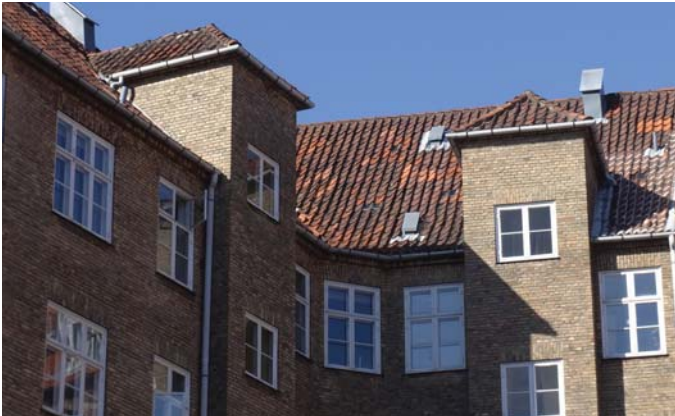
Udskiftning af væsentligt nedslidt tagbeklædning
