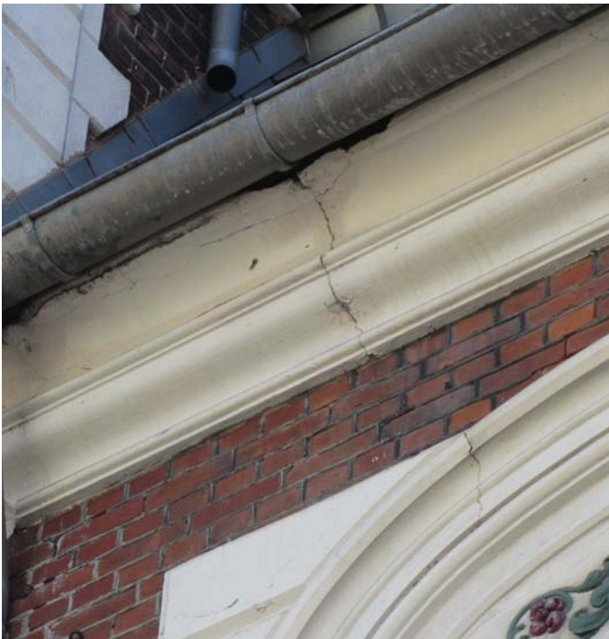
Der ses store sætningsrevner på gadefacaden
