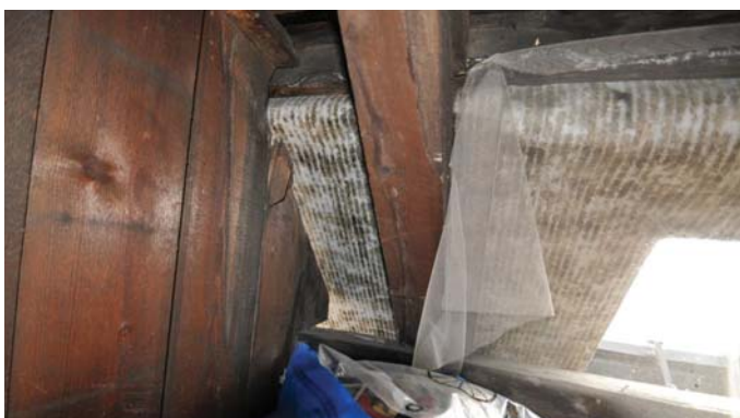
Skimmel på tagkonstruktion udbedres og ventilation forbedres
