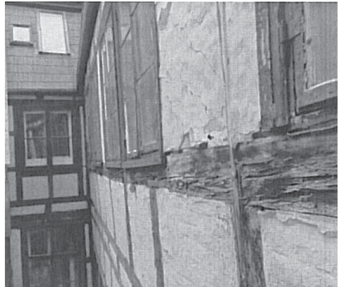
Mod gård er der bindingsværk, der trænger til istandsættelse
