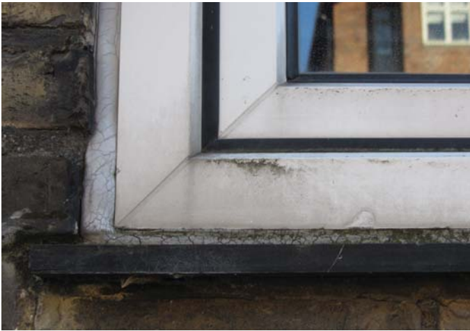
Fuger omkring vinduer nedslidte og utætte
