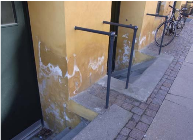
Tydelige fugtproblemer udvendigt på gadefacade
