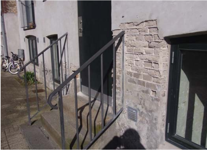
Tydelige fugtproblemer udvendigt på gårdfacade
