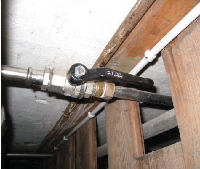
Uisolerede varme og vandrør isoleres
