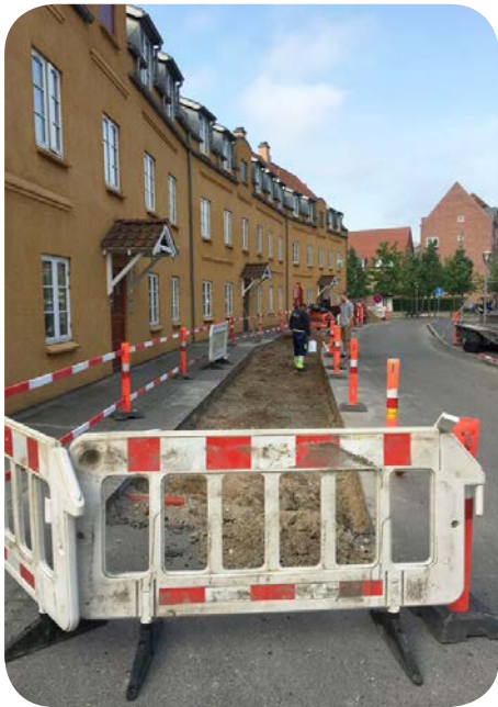
Anlæg af privat klimatilpasningsprojekt på Erik Ballingsvej, som er finansieret af HOFOR. Projektet er et privat klimatilpasningsprojekt, der er finansieret af HOFOR.
