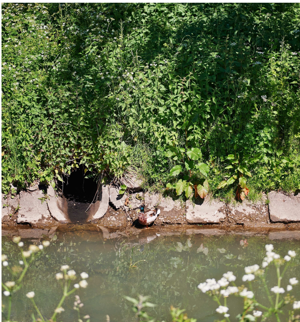
Regnvandsudløb ved Harrestup Å. Foto: HOFOR
