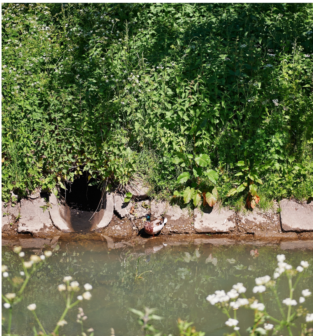
Regnvandsudløb ved Harrestup Å. Foto: HOFOR
