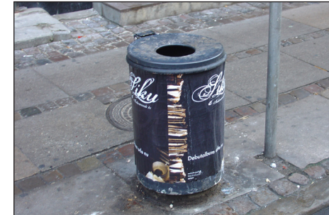
Facader og gadeudstyr er godt brugt.
