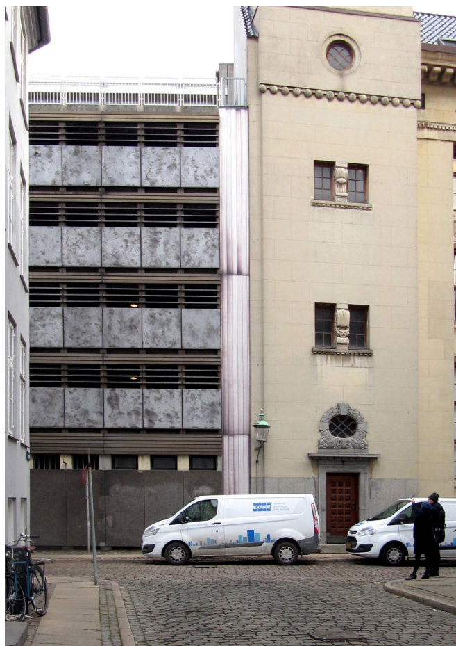
Sammenstød mellem det eksisterende p-hus og den bevaringsværdige bygning på Asylgade 7.
