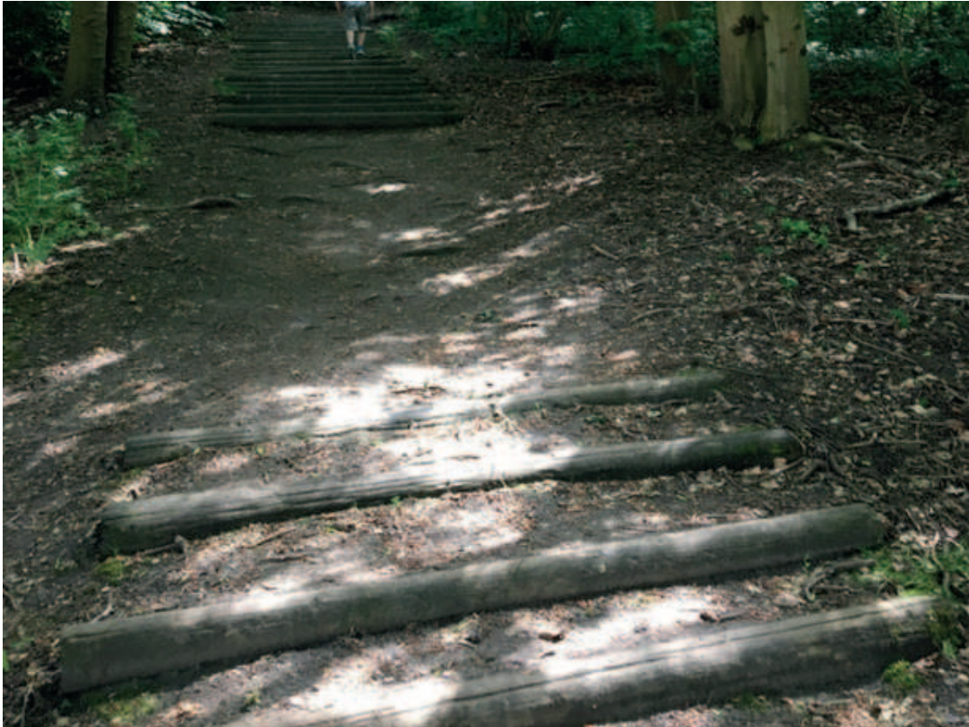
Billede 2 Trappe til friluftsscenen, hvor træforkanter mangler, 2018.
