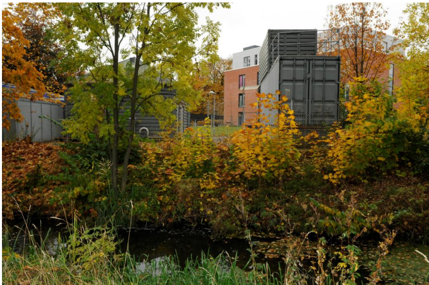
Figur 12 Actiflo®-anlægget ved Emdrup Sø.
