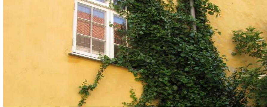
Eksempel, der viser en Efeu, som kræver beskæring for ikke at skade bygningen.
