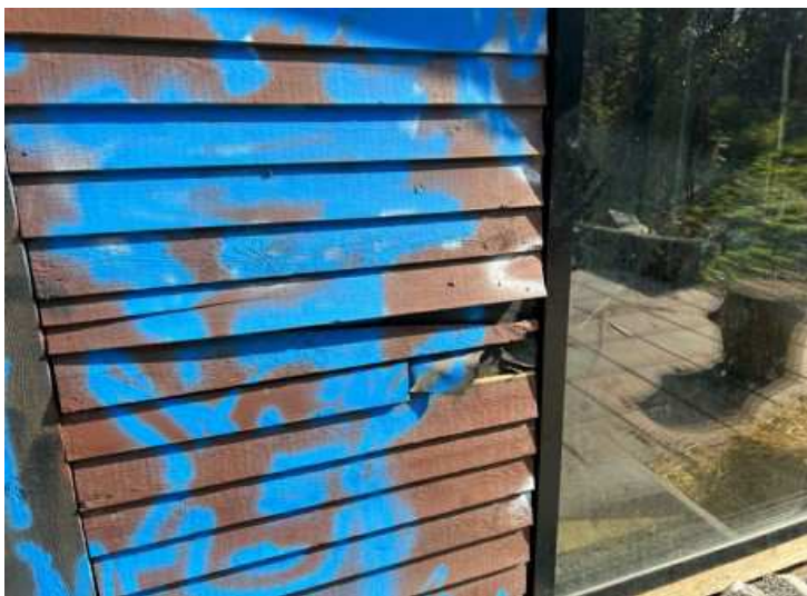
facader med skader på træværk- mangler
