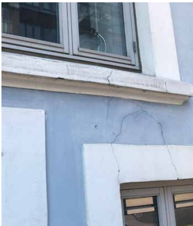
Nedslidte murbånd, sølbænke og revner reparerer.
