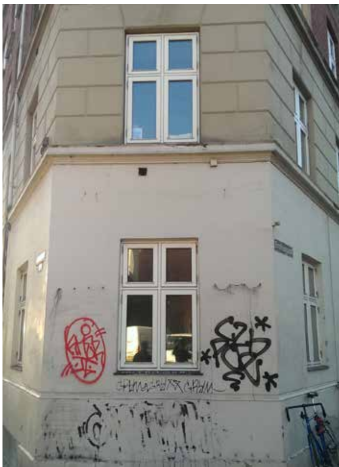
Underfacade er nedslidt og renses af inden ny åndbar maling
