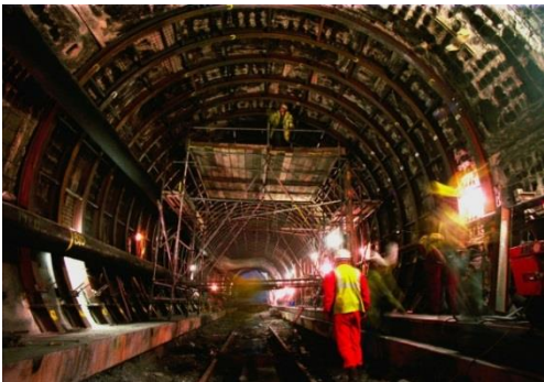
Brand i tunnelen under Den Engelske Kanal (Eurotunnel), England 2008
