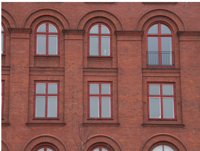
Foto 20. En fransk altan kan i nogle tilfælde være en løsning i stedet for en rigtig altan. I dette tilfælde er den franske altan placeret alene, og facaden vil få et mere homogent udtryk, når de øvrige felter også får etableret franske altaner.
