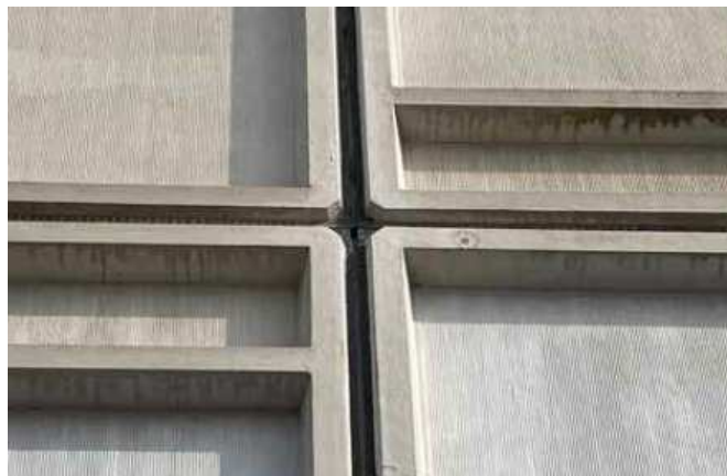
Betonskader Fuger mellem facadeelementer, fra husets opførelse, er nedbrudt af almindelig ælde. Betonpanelerne har slået revner.
