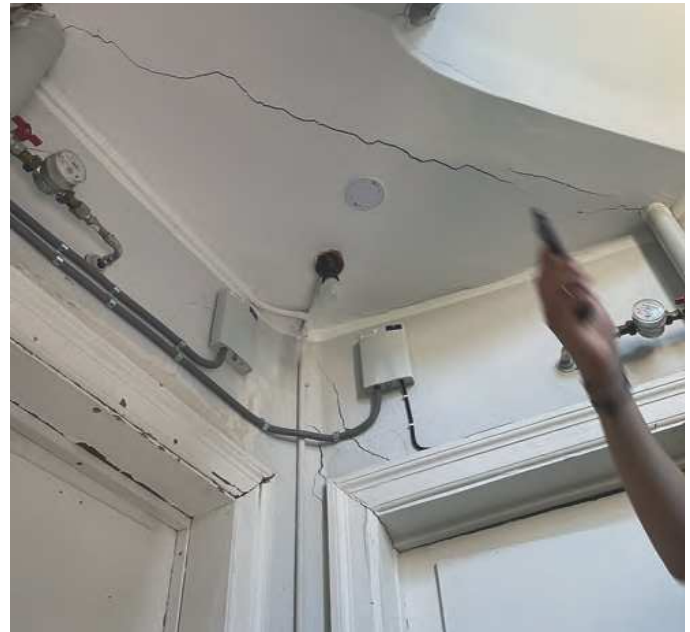
Sætningskader indvendigt, kælderkonstruktion understøttes
