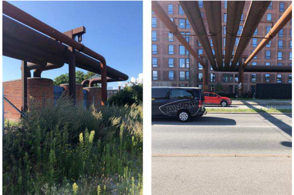
Figur 6-3 Tv. Det tekniske anlægs facader og rør mod øst. Th. de rustrøde rør hen over Vasbygade. Foto Cobe.
