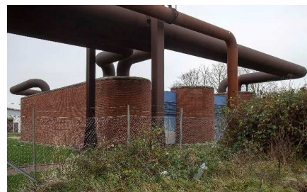
25. Teknisk anlæg ved Vasbygade.
