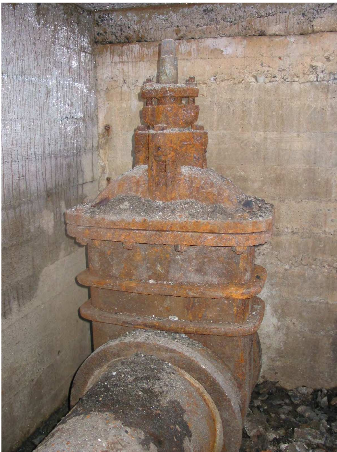
Foto 3 Ventil i bygværk
