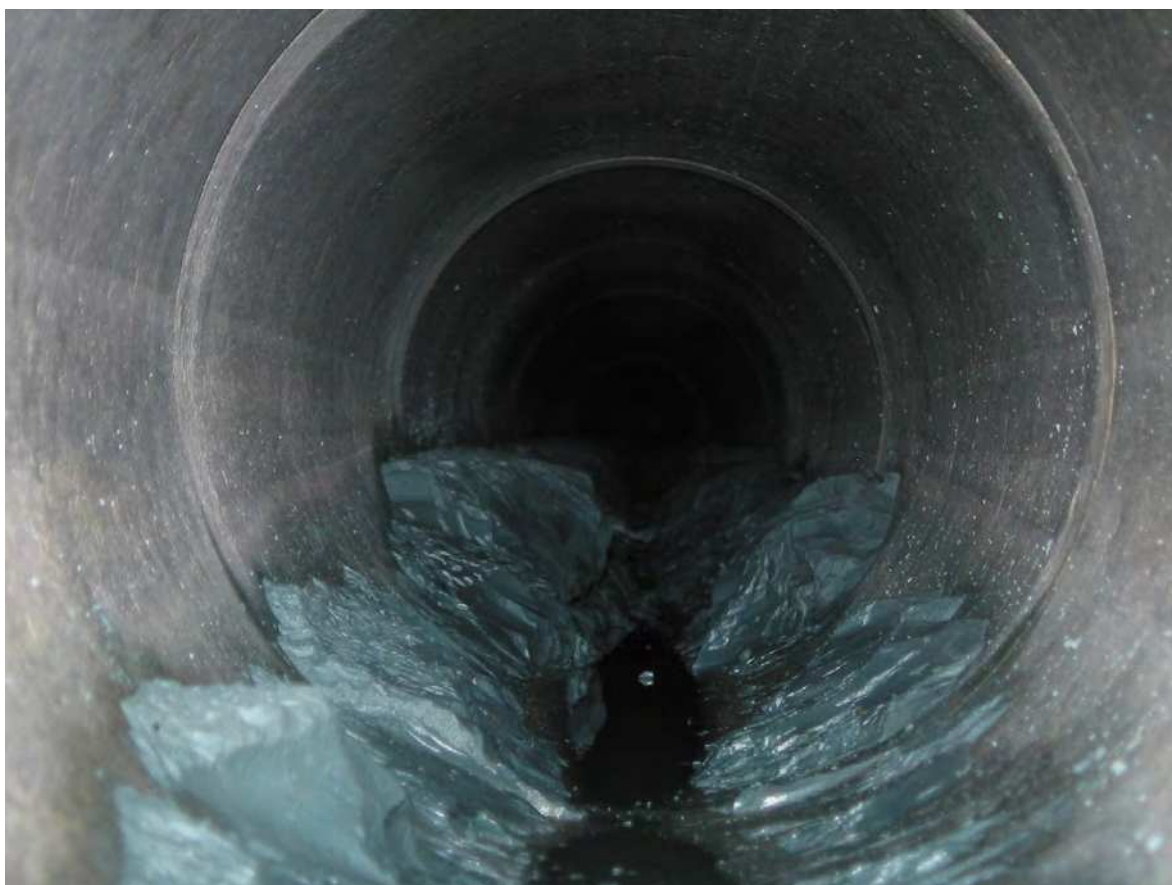
Foto 5 Ledning med fastkittet betonslam
