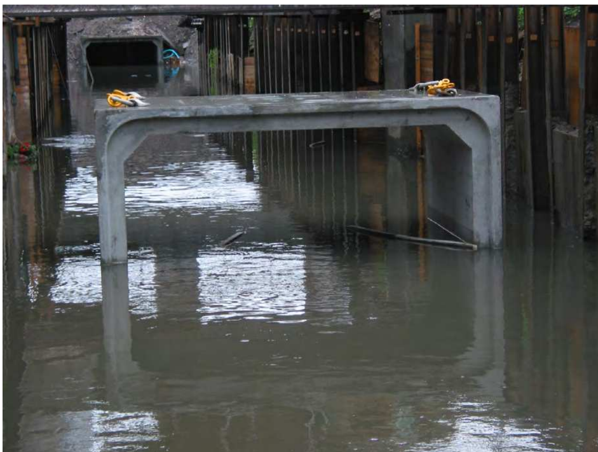
Foto 12 Oversvømmelse af anlægsarbejder på Lersøgrøften
