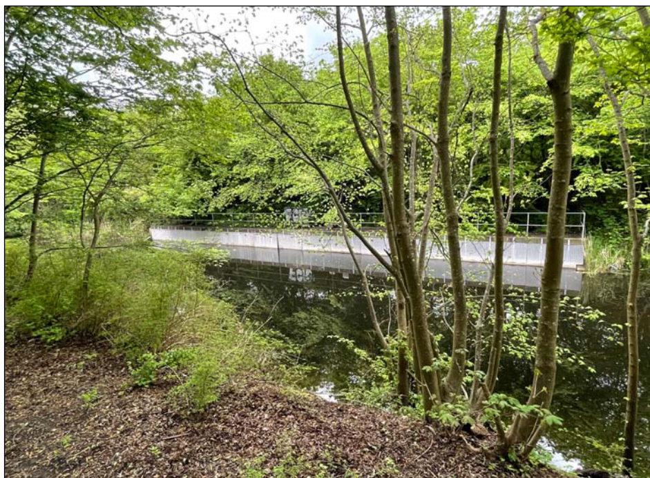
Gladsaxe Kommunes kloakoverløb U11 Sådan ser udløbet til Fæstningskanalen ud idag. Foto: Jakob Engbæk
