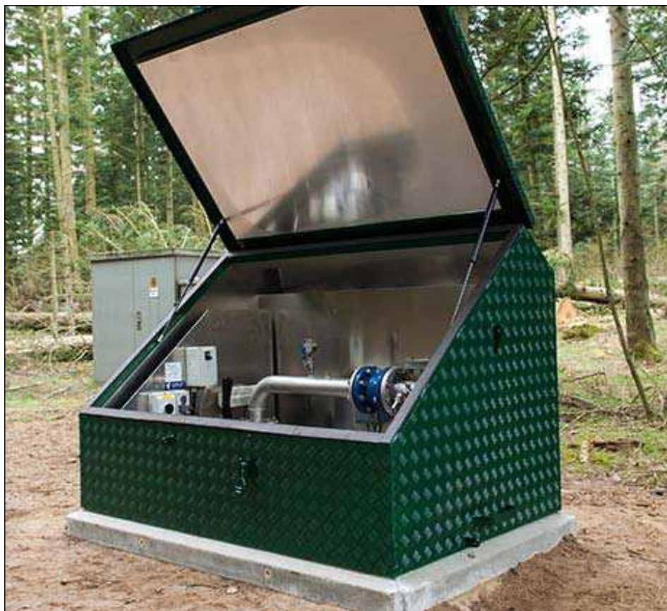
At finde vand er sommetider lidt lunefuldt, men når boringen er på plads, fylder et pumpeanlæg ikke mere end en lille boks som denne.
