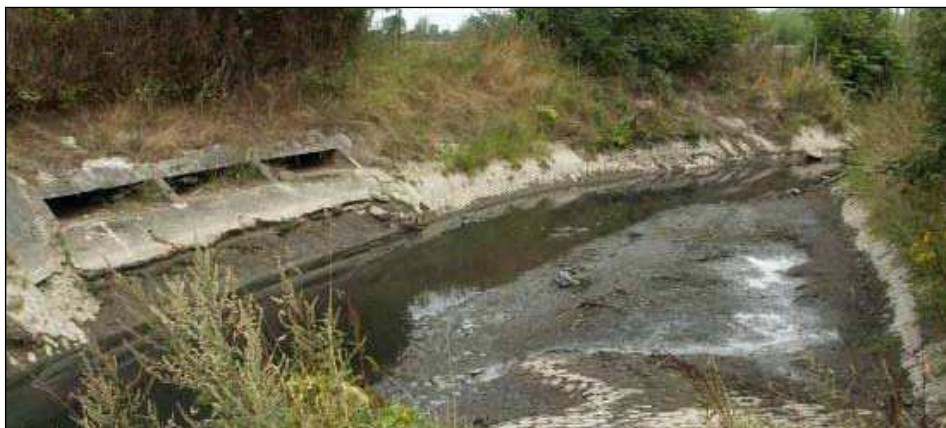
Kloakoverløb til Harrestrup Å
