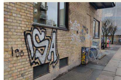
Graffiti på bygning
