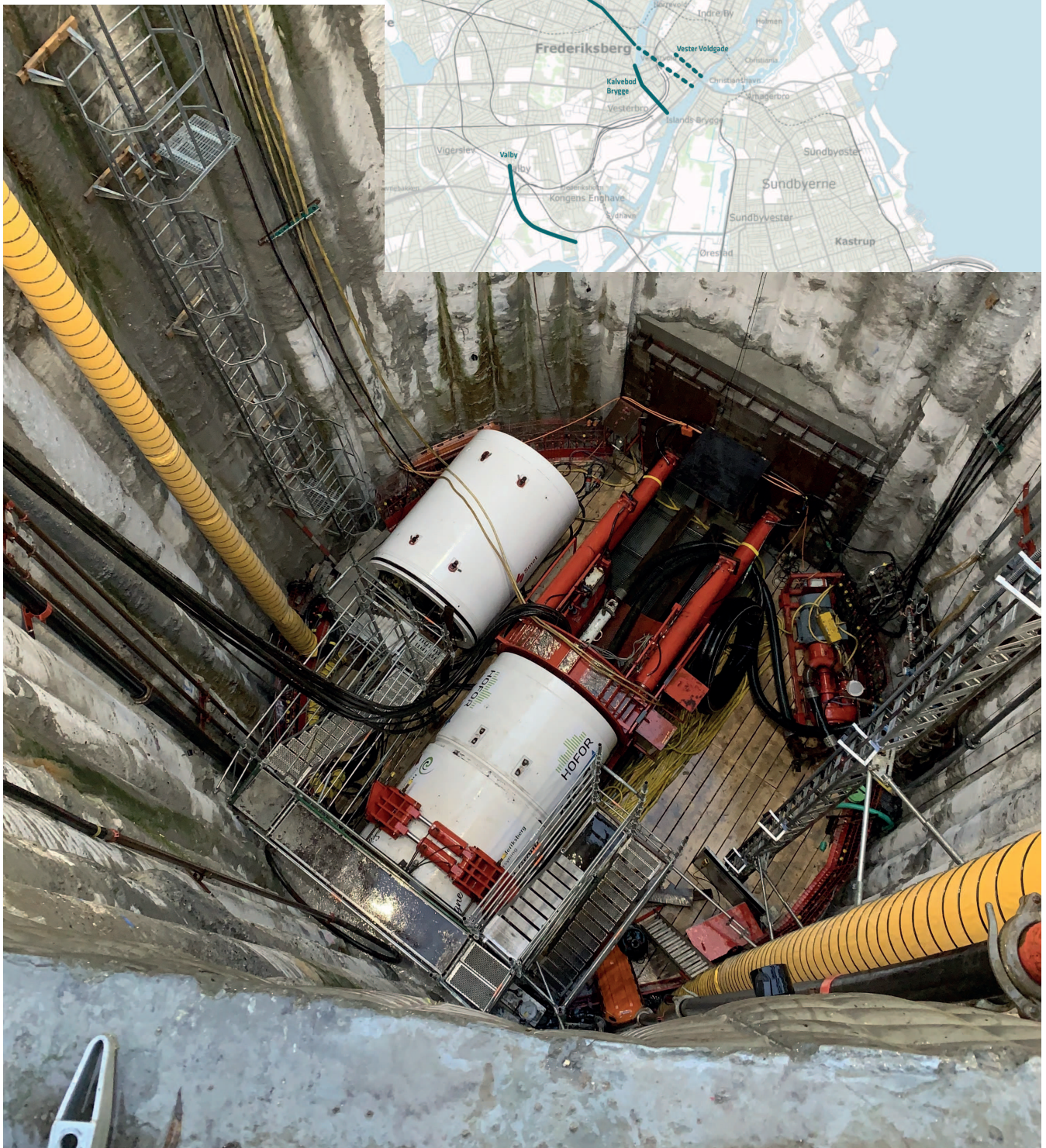
↑ Kalvebod Brygge Skybrudstunnel, foto HOFOR
