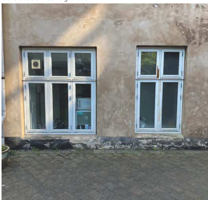
Gårdfacade med fugtskader
