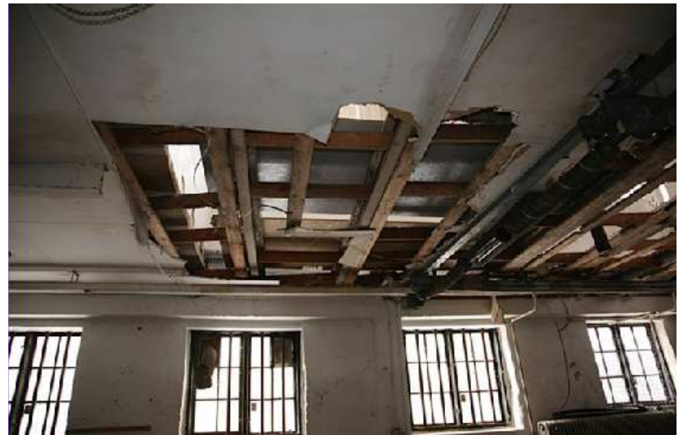
Bygning 3 Nedslidt svampeangrebet hal - gennemtænkt etageadskillelse
