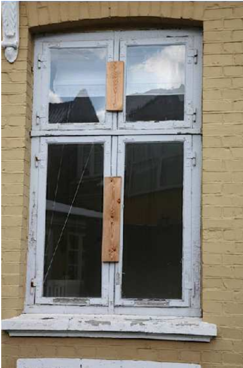
Bygning 1 Tilsømmet vindue
