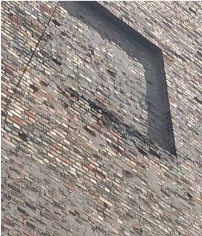
Gavl er i dårlig forfatning og isoleres.
