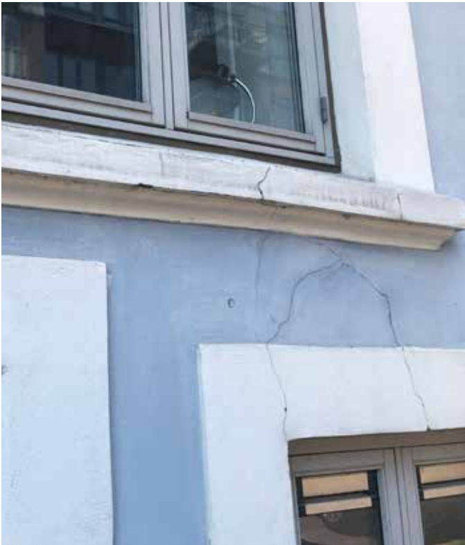
Nedslidte murbånd, sålbænke og revner reparerer.
