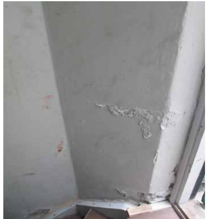
Synlige tegn på opfugtning af kældernedgange
