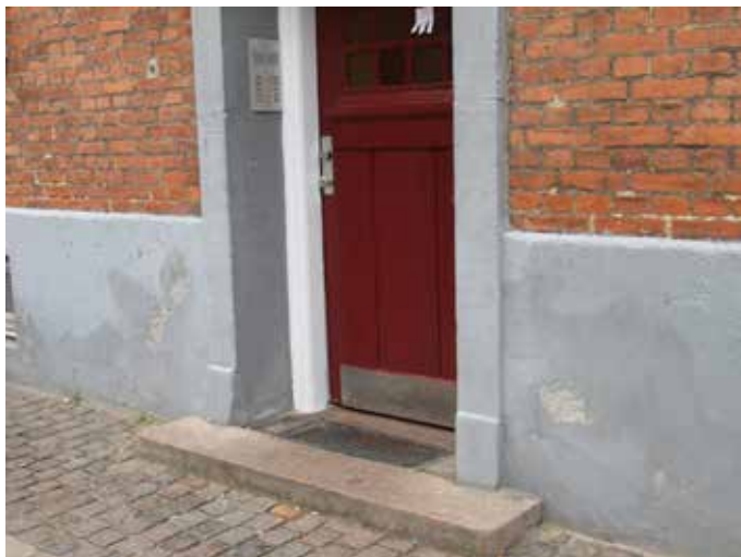
Synlig opfugtning af facade afhjælpes ved omfangsdræn
