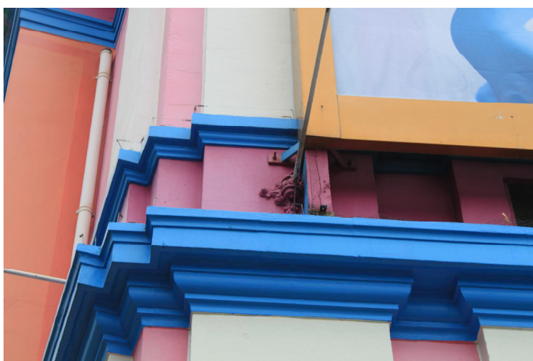
Gamle forankrin- ger og beslag svækker murværk
