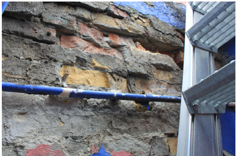
Indvendig i åbent tårn, hvor mur- værket er meget medtaget.
