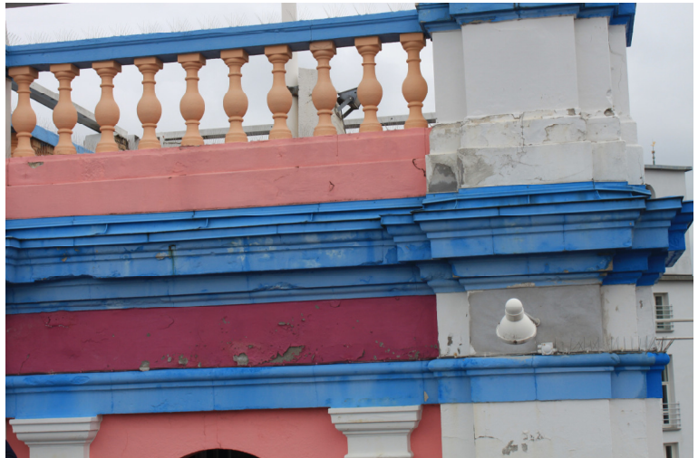
Tydelige skader på yderside af tårn mod Axeltorv
