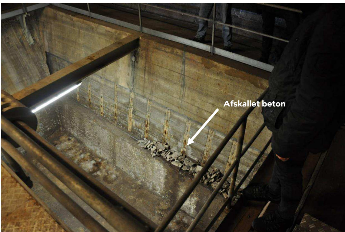
Afskallet beton fra kontravægten
