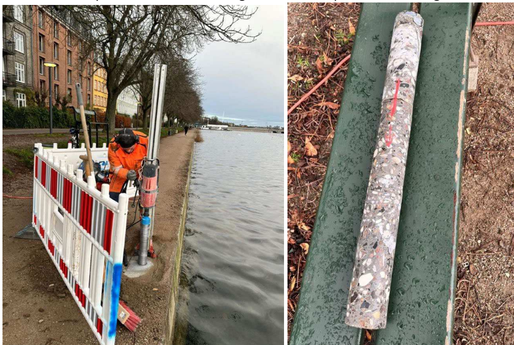
Figur 5: (Venstre) Udtagning af borekerner fra overside. (Højre) billede af udtaget borekerne ID nr. 5.
