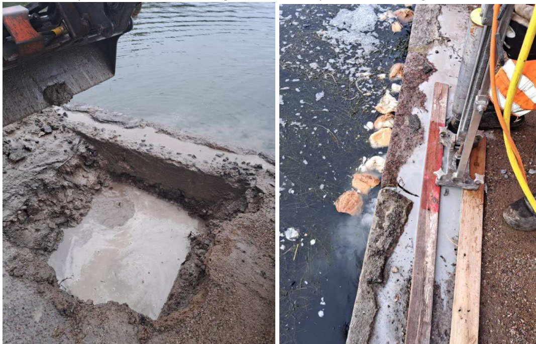
Figur 4: (Venstre) prøvegravning fyldt med indtrængende vand. (Højre) udtagning af borekerner fra overside.
