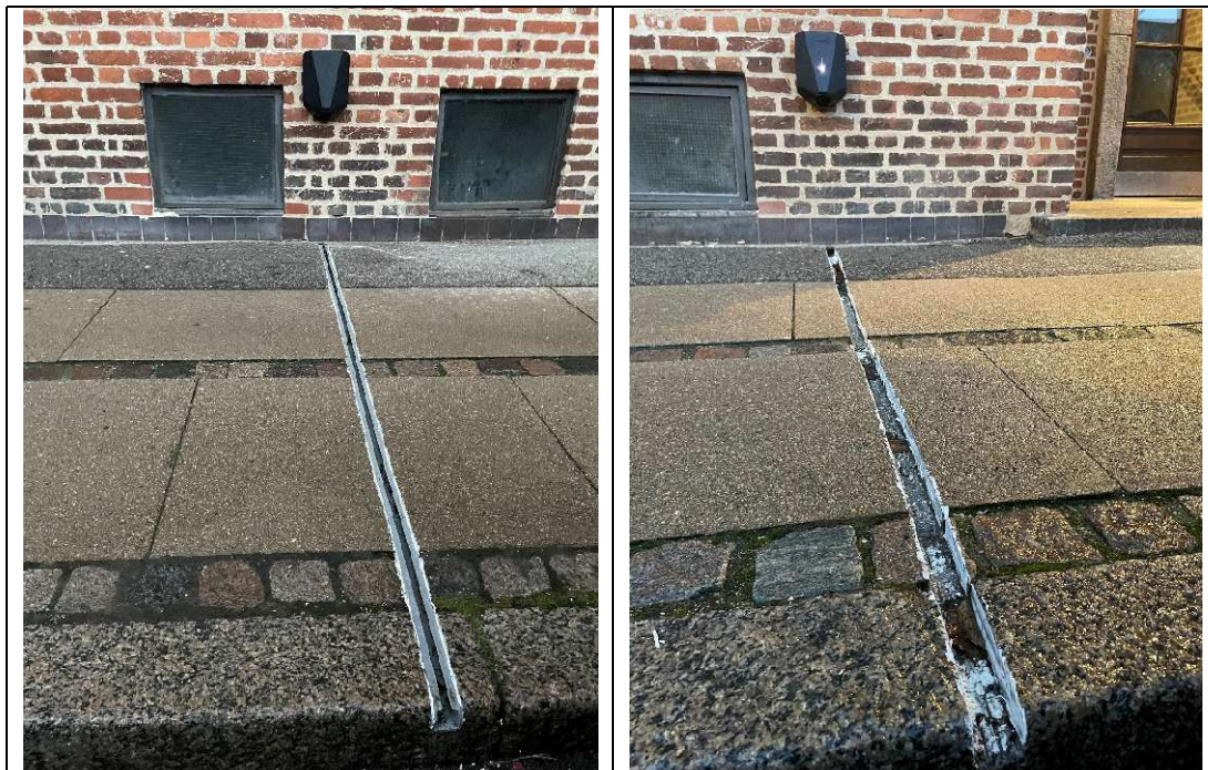
Figur 2 Eksempel på løsning kabelskinne på offentlig fortovej hvor ladepunktet er til en lukket brugergruppe
