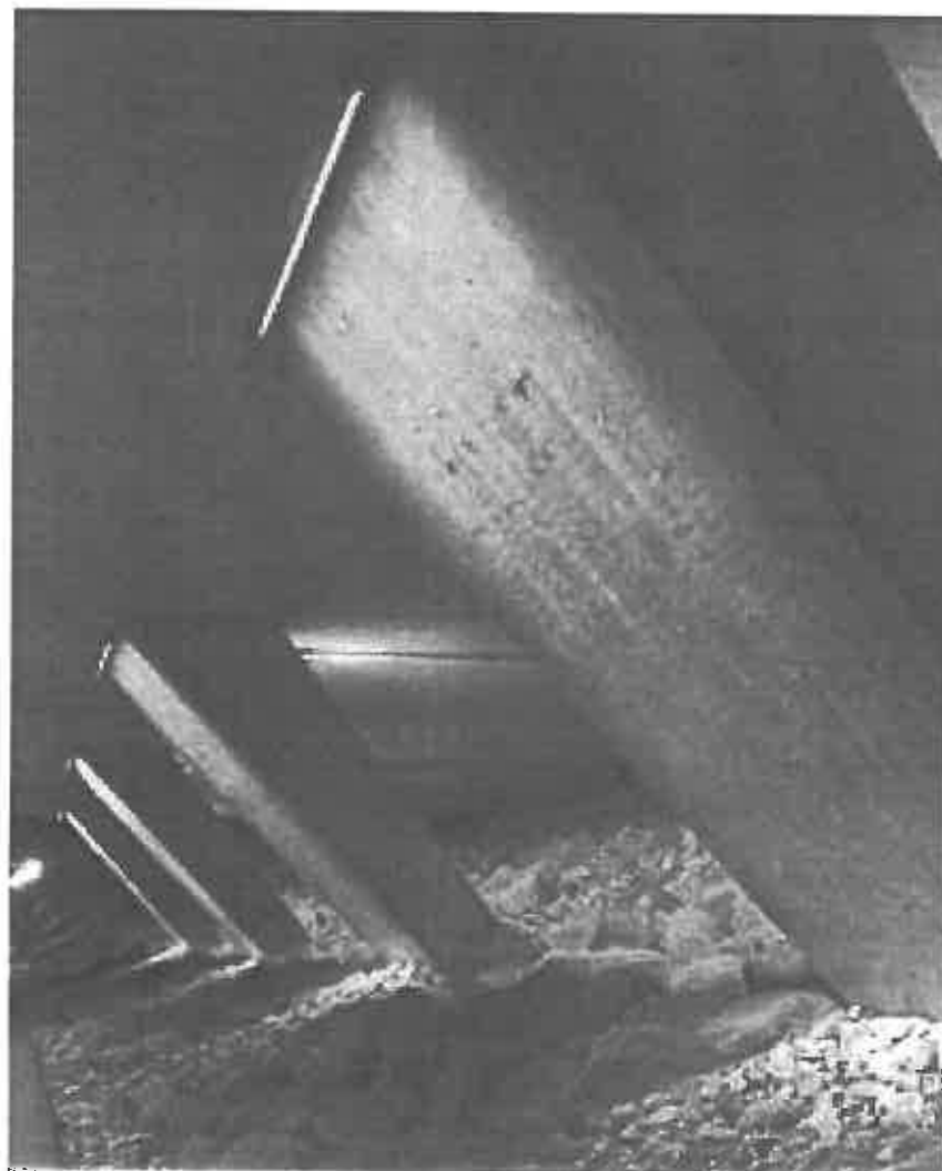
GLADSAXEVEJ: TILVÆRDSKARSENDE TUNNELBELYSNING
