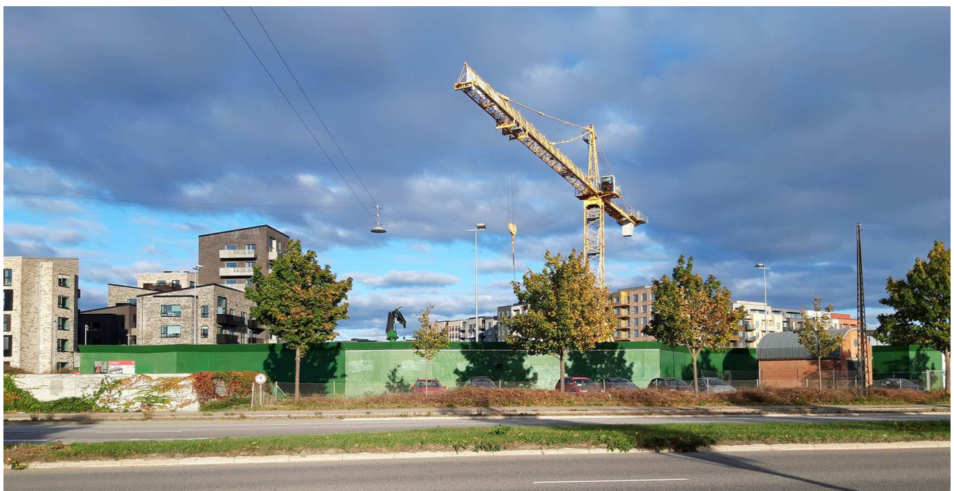
Området for den kommende stationsplads til Sluseholmen Metro set fra vejen Sjællandsbroen.
