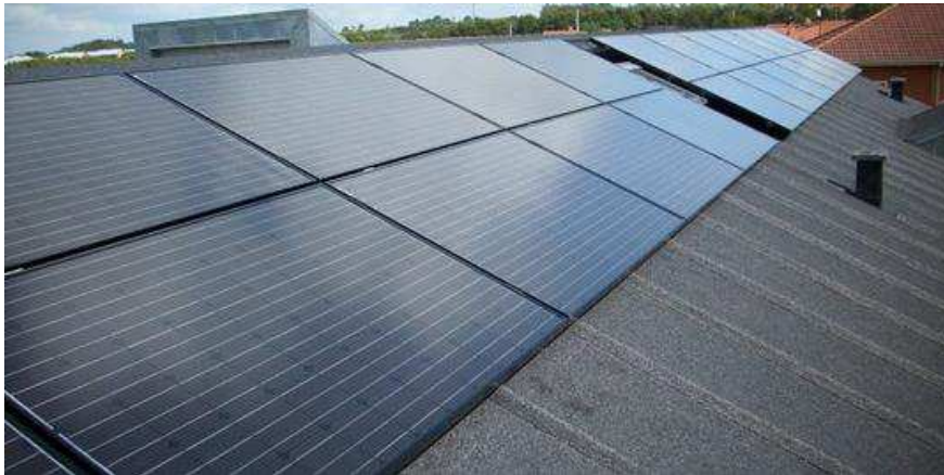
Figur 5: Billede; CIRKEL ENERGI WEBSHOP. Eksempel på solceller monteret på tag beklædt med tagpap. Samme oplægningsmetode forventes at kunne benyttes. Befæstelsen udføres i tagets spær med skærmskiver, bolte og tætningsmateriale.
