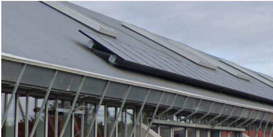
Figur 5: Billede; GoogleMaps. Montagesystem på eksisterende solcelleanlæg på Hafnia Hallen
