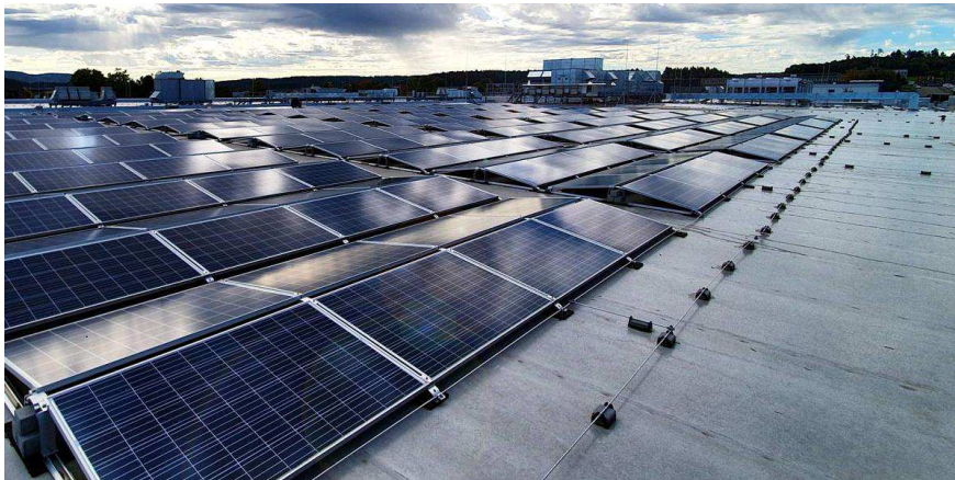
Figur 8: Billede; SENS Iqony Solar Energy Solutions. Eksempel på solceller monteret på tag beklædt med tagpap. Samme oplægningsmetode forventes at kunne benyttes. Befæstelsen udføres med ballast.
