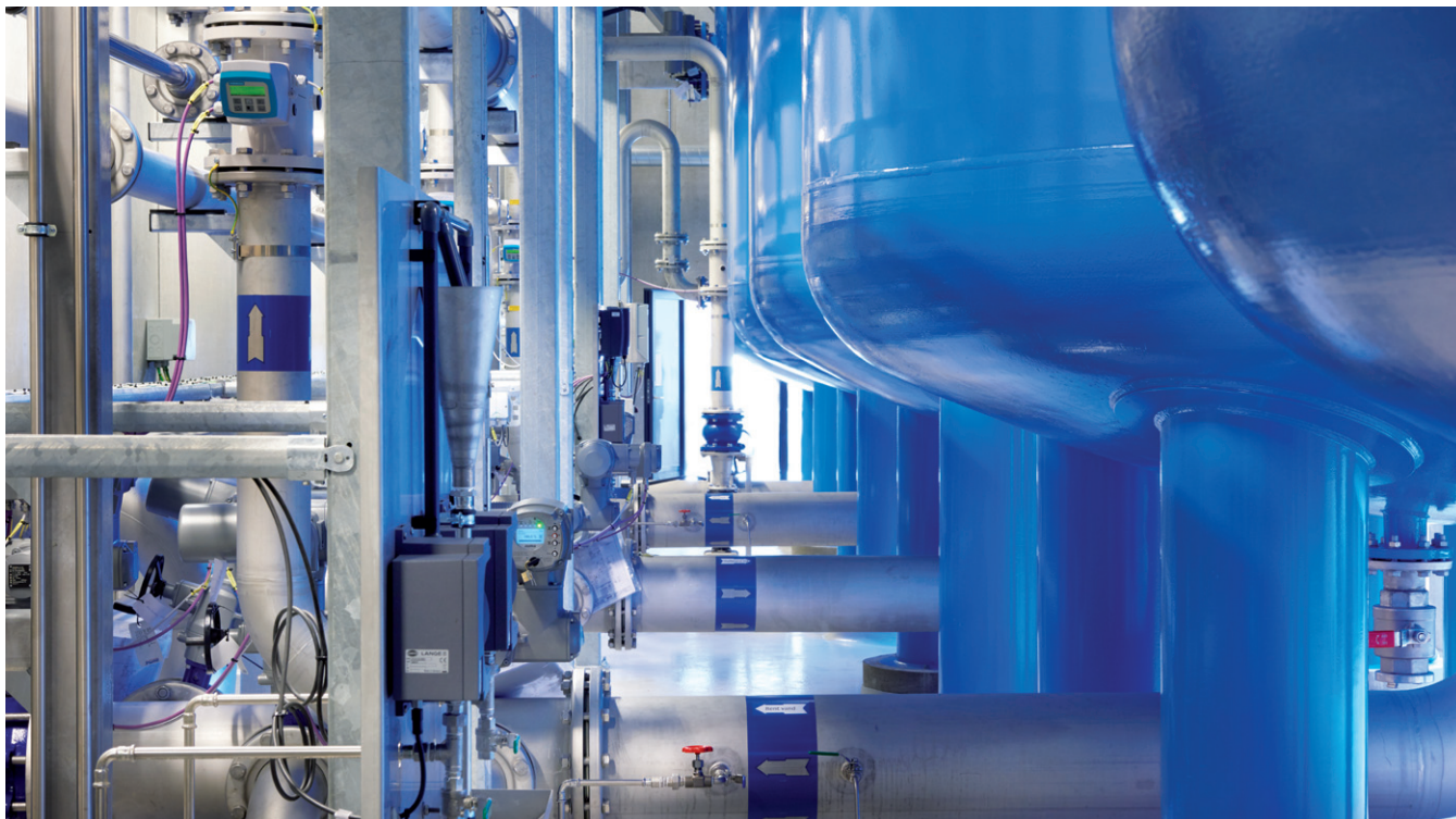
I foråret 2015 åbnede HOFORs nye vandværk 'Værket ved Marbjerg', og der var stor interesse for de nye teknologier.
