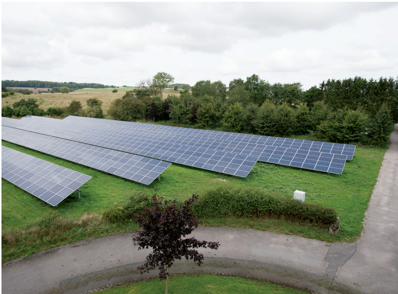
HOFOR installerer solcelleanlæg på vandværker og pumpestationer, så den strøm HOFOR bruger på at pumpe vand til og spildevand fra kunderne bliver mere bæredygtig.
