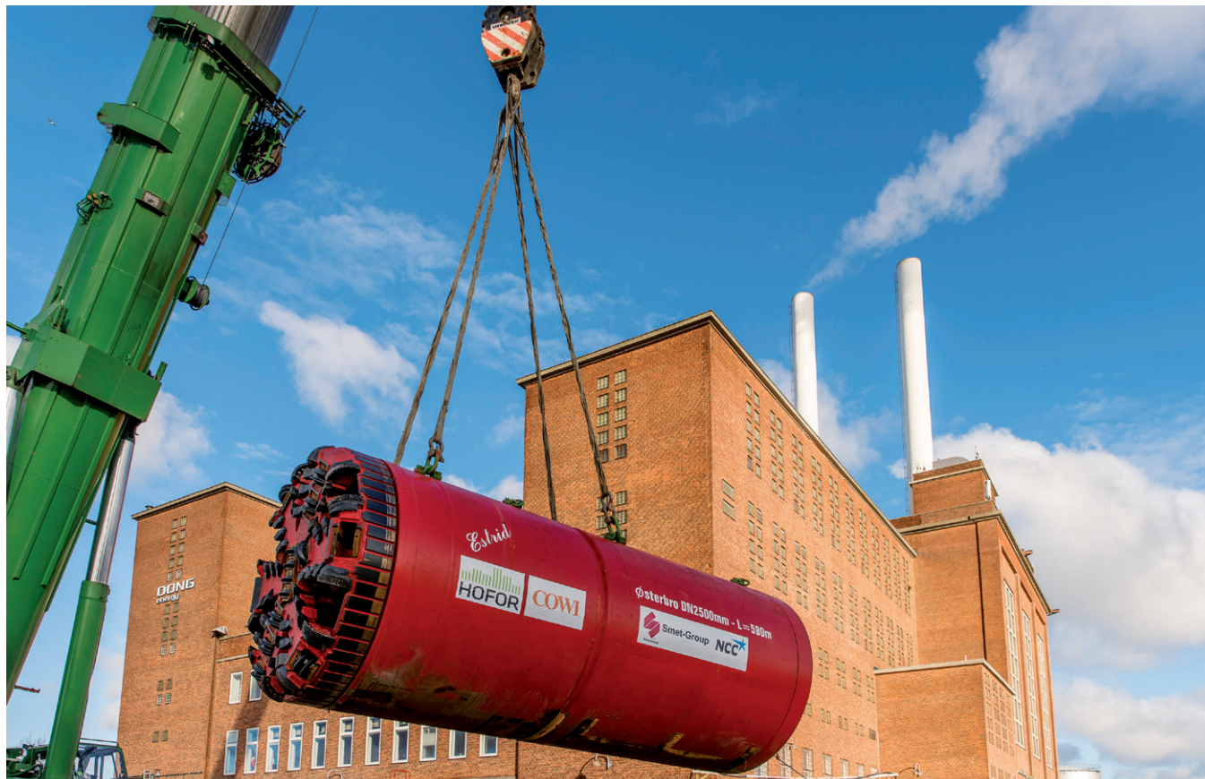
Tunnelboremaskinen Estrid bliver sænket ned og gjort klar til at bore regnvandstunnel på Østerbro.
