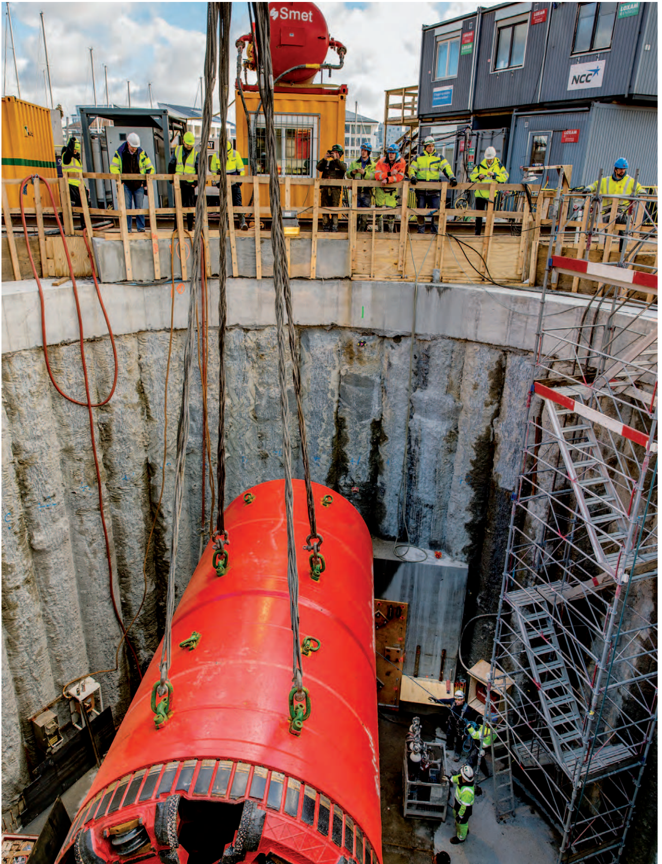
På Østerbro skal en regnvandstunnel være med til at sikre Ydre Østerbro mod oversvømmelser. Tunnelboremaskinen Estrid blev sænket ned i jorden i starten af 2016.
