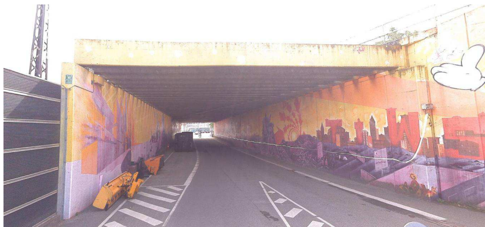
Figur 8-9 Bro 11640 fag 1 set fra vest mod øst. Her ses tydeligt de simpelt understøttede topbjælker der udgør understøtningen af Ringbanen.
