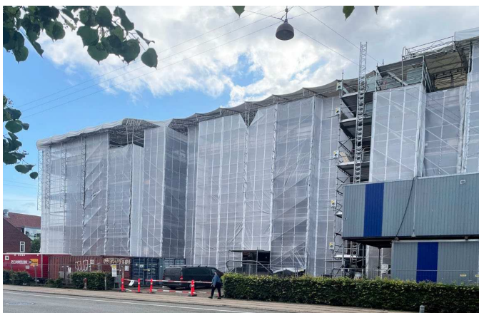
Lokalplanområdet set fra Randersgade mod øst. Her ses Heibergskolen, der er under renovering.
