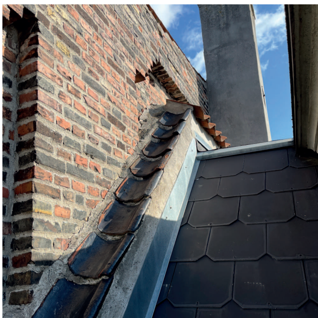
Taget er væsentligt nedslidt
