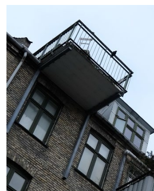
Altan med udkragning i tagetagen, der ikke længere vil kunne tillades.
