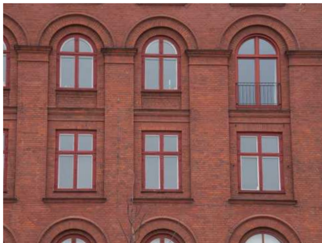
Foto 20. En fransk altan kan i nogle tilfælde være en løsning i stedet for en rigtig altan. I dette tilfælde er den franske altan placeret alene, og facaden vil få et mere homogent udtryk, når de øvrige felter også får etableret franske altaner.
