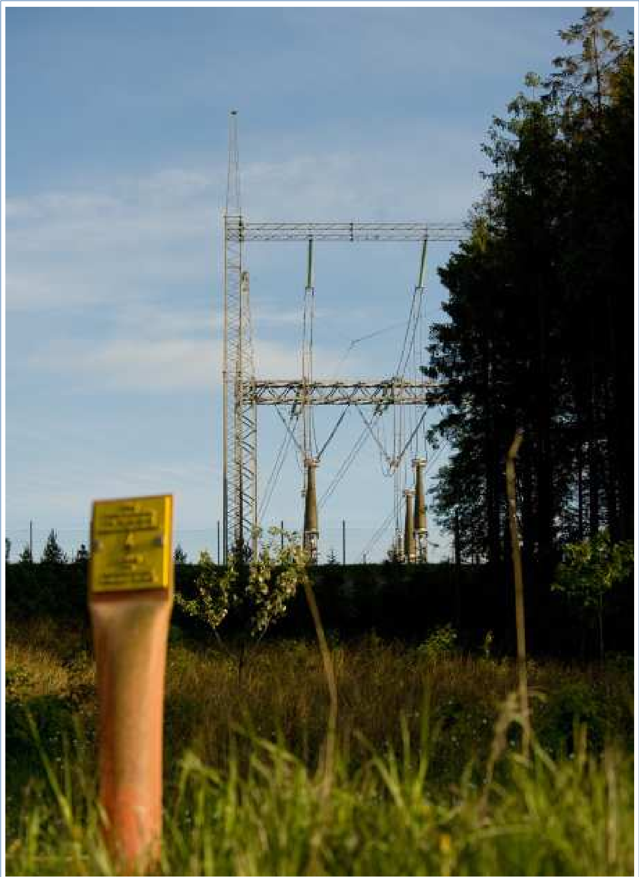
I en kabelstation føres ledningerne ned i jorden. En pæl markerer, hvor kablerne er nedgravet. Også ved jordkabler er der magnetfelter. Se eksempler i "Katalog over magnetfelternes størrelse ved forskellige anlægstyper".
