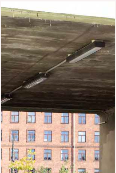
Påbygget armatur: Fagerhult 'Tuscan'
