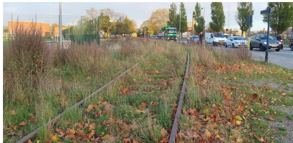
Sporet er i den østligste del af delområdet løftet væk fra sit oprindelige tracé i forbindelse med kloakarbejder. Det ligger nu på en vold af opgravet jord, hvilket gør det udsat.
