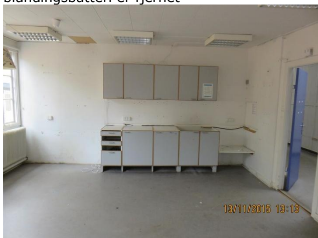
Køkken er stærkt nedslidt, hvidevarer, vask og armaturer er afmonteret
