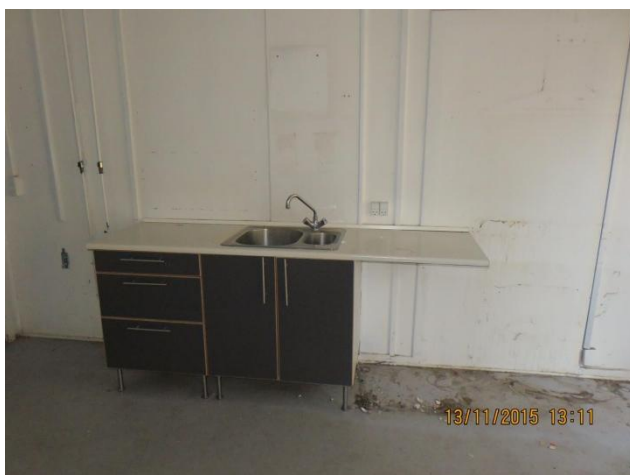
Køkken er stærkt nedslidt, hvidevarer er afmonteret
