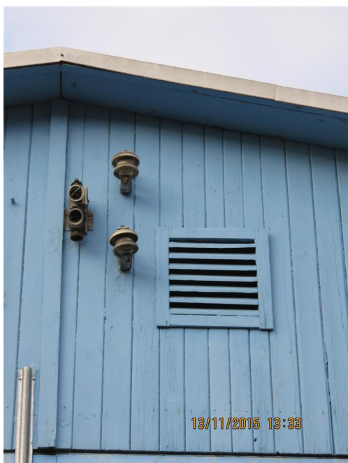
Ventilations trærist til loft, gamle forbindelser til luftledninger
