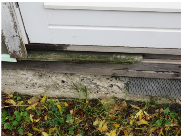
Udluftningsrist til krybekælder
