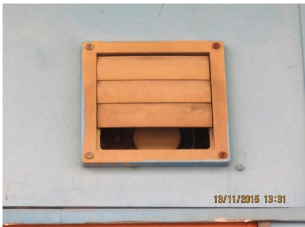
Lamelventil med manglende blad
