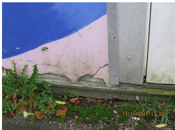
Gavl mod nord, revner i eternit beklædning
