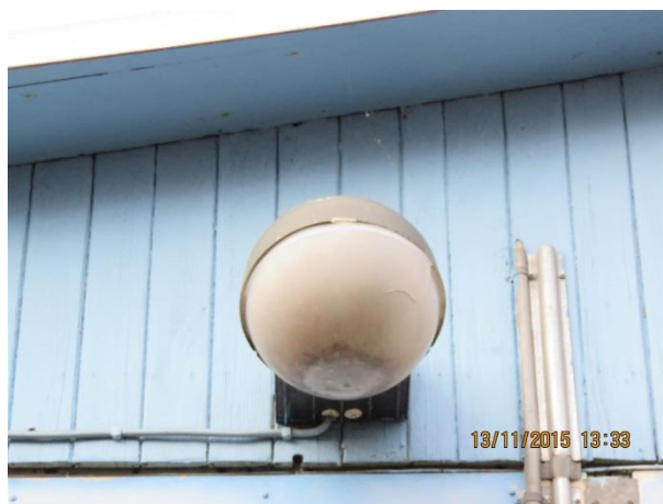
Itugået lampe, med spor efter indtrængende vand
