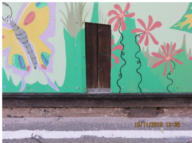
Facade mod vest, afskallet eternitbeklædning
