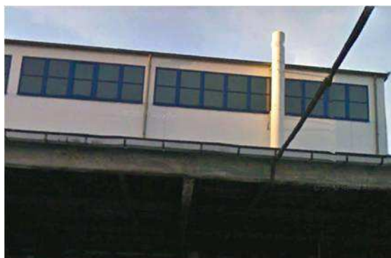
Figur 9-4 Afkastene på Maskincentralen når i dag op i en højde af 12 m over jordoverfladen, men skal med projektforslaget være 8 m højere, dvs. i alt 20 m.
