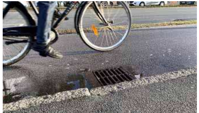
Afløbsrist med lamellerne vinkelret til køreretning på cykelstien på Ørestad Boulevard
